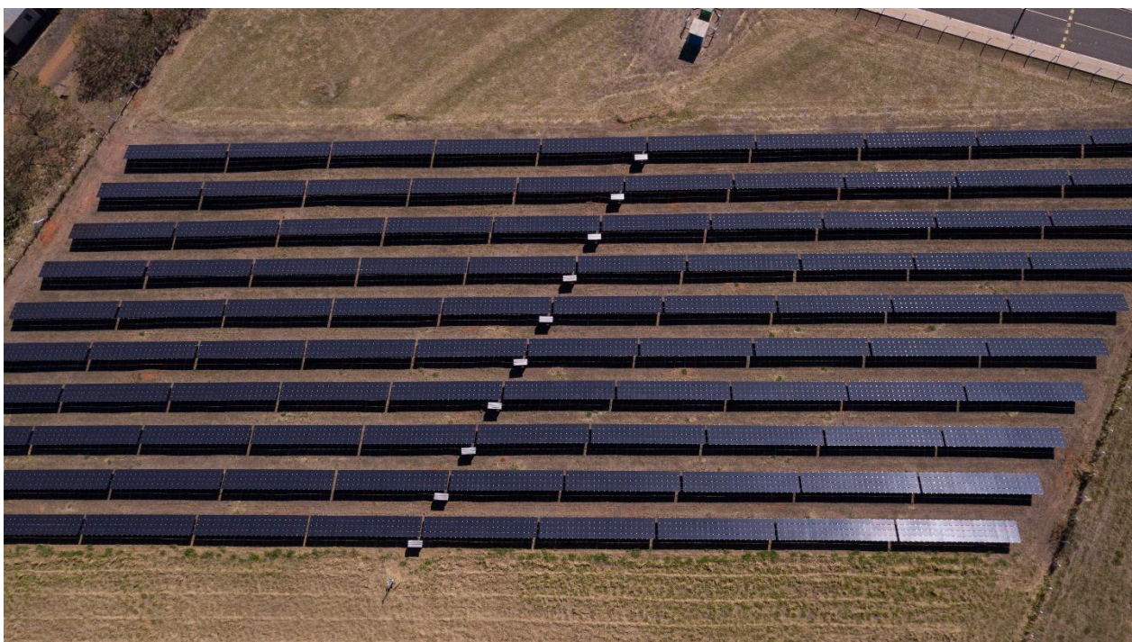
Figura 3 - Vista aérea – Usina Fotovoltaica
